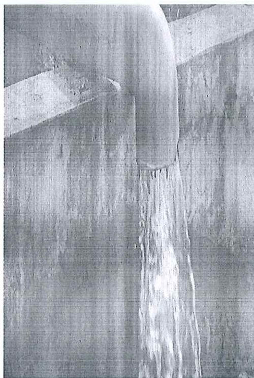
Nước thải từ bể lắng xuống hồ sinh học
